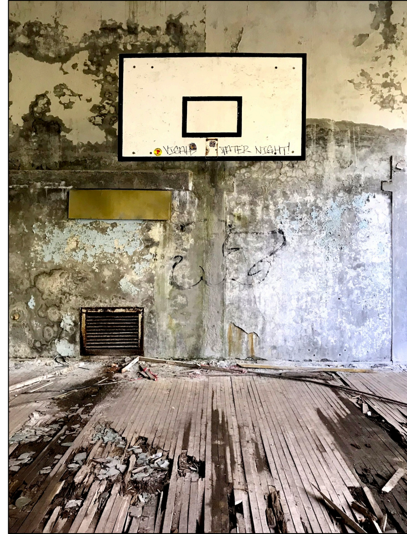
El gimnasio, también en avanzado estado de deterioro, contaba con canchas de basket y fútbol.
